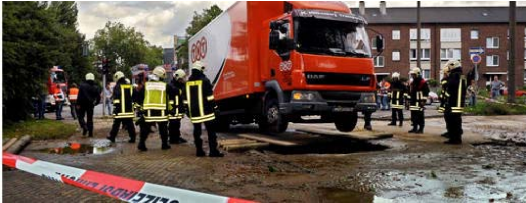
Lastwagen nach Rohrbruch abgesackt.
